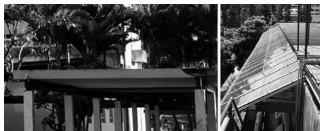
Fig. 5.1 Detalhes do gerador fotovoltaico do sistema de 2 kWp no prédio da Engenharia Mecânica da UFSC
